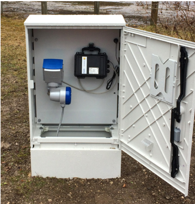
Bild 2: Messumformer und Schraml FWD Datenlogger mit GPRS-Modem im Schaltschrank
