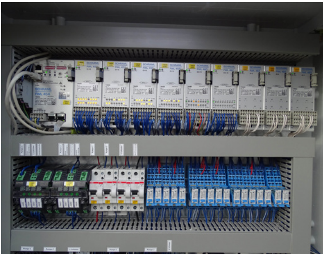
Bild 5: Schaltschrank mit Fernwirk- und Automatisierungstechnik von Schraml
