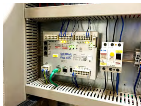
SCHRAML Fernwirkstation und SPS FWL 455 im Schaltschrank des Hochbehälters Klais
