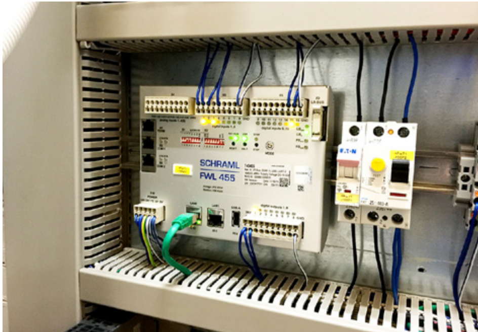
Bild 3: SCHRAML Fernwirkstation und SPS FWL 455 im Schaltschrank des Hochbehälters Klais
